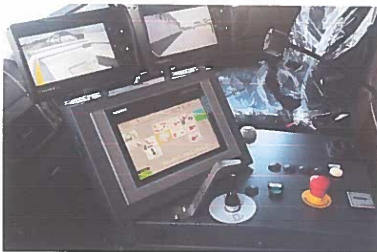
Figura 27: consolas y cuadro de mandos en la cabina
